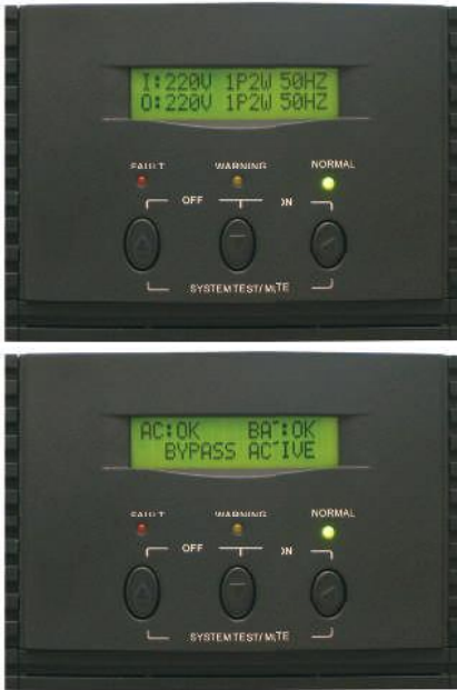
MHD 10kVA Display
